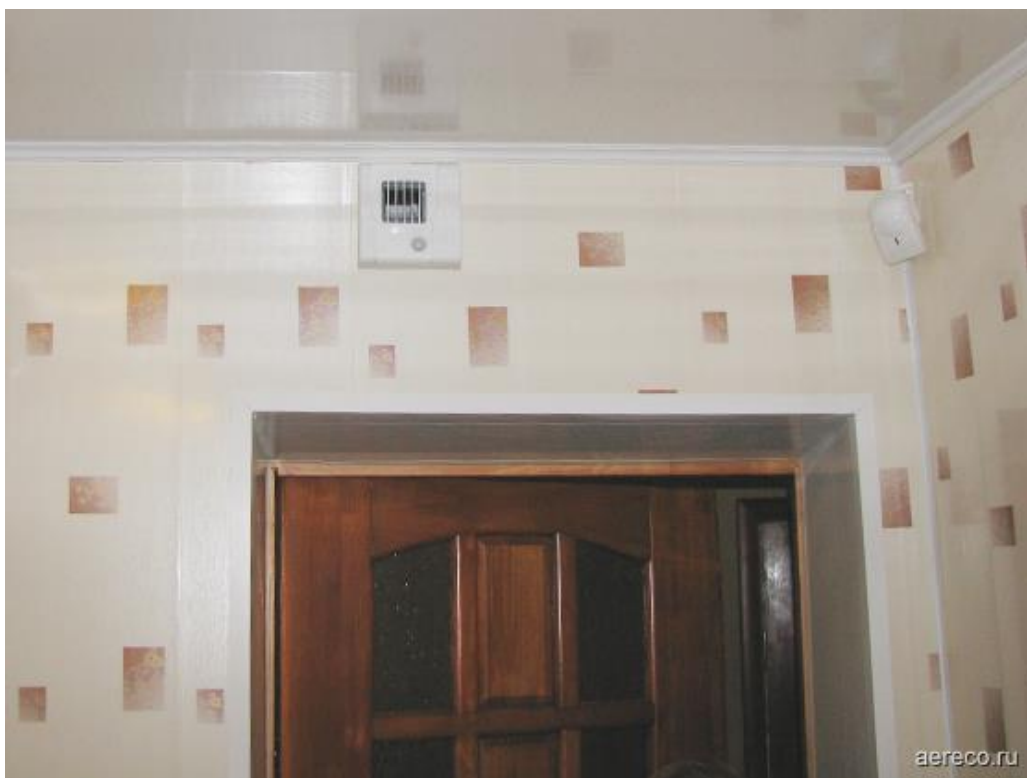
Вытяжное устройство BXS с датчиком присутствия, установленное в коридоре на первом этаже дома.
