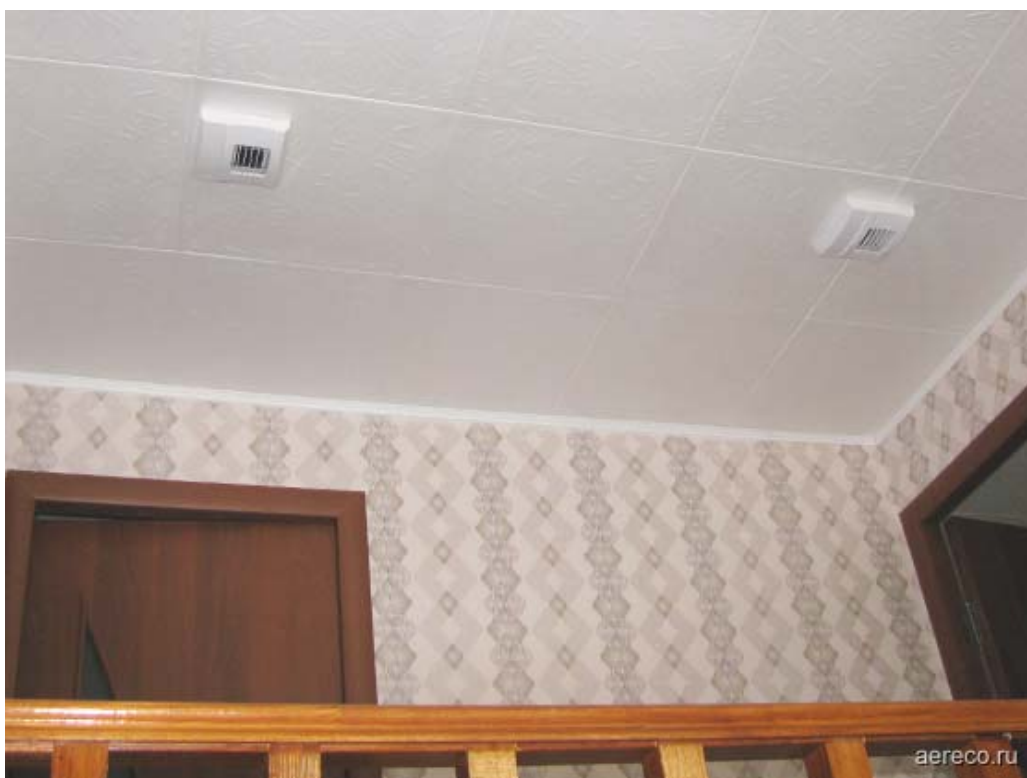
Вытяжные устройства ВХС, установленные на потолке второго этажа.
