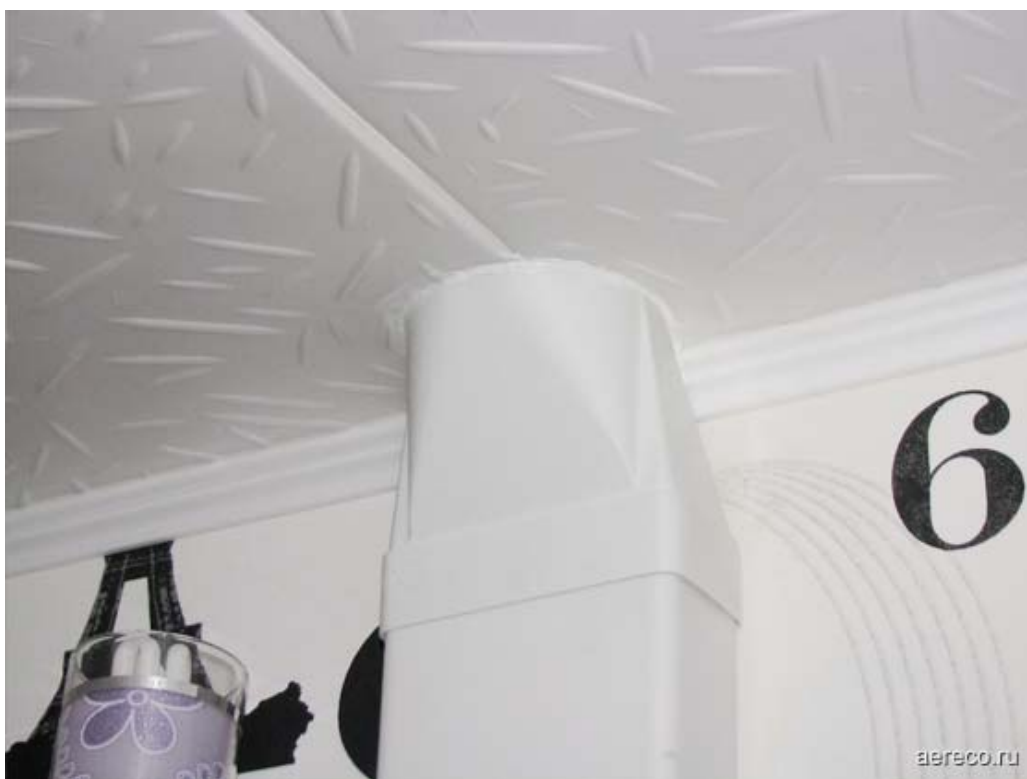
Соединение воздуховода с потолком.
