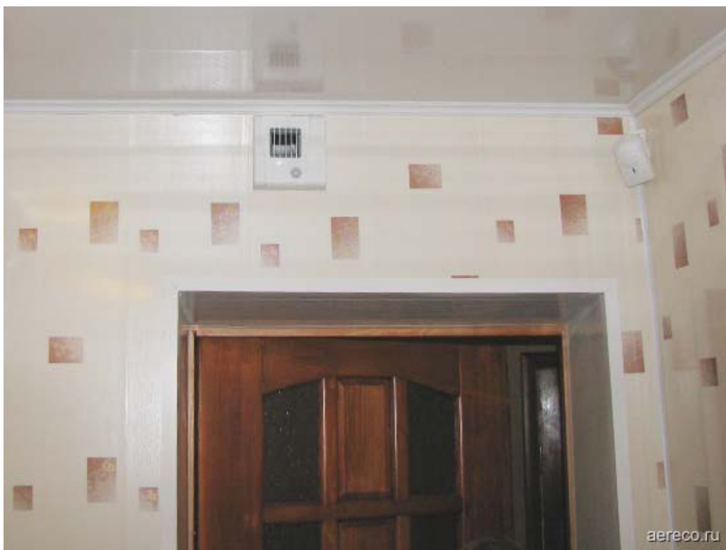
Вытяжное устройство ВХС с датчиком присутствия, установленное в коридоре на первом этаже дома.
