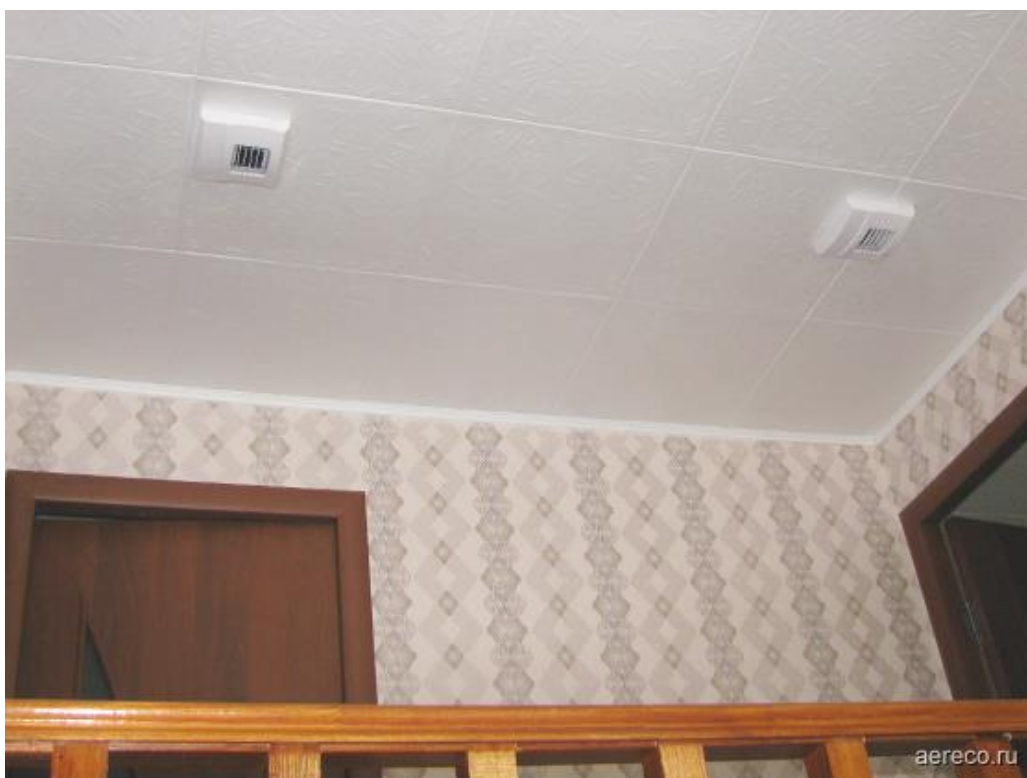
Вытяжные устройства BXS, установленные на потолке второго этажа.
