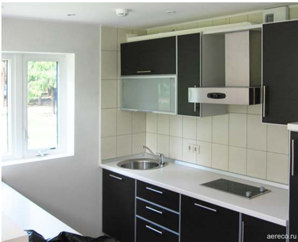
Установленное на кухне гигрорегулируемое вытяжное устройство ВХЛ обеспечивает расход воздуха до 150 м 3 /ч.
