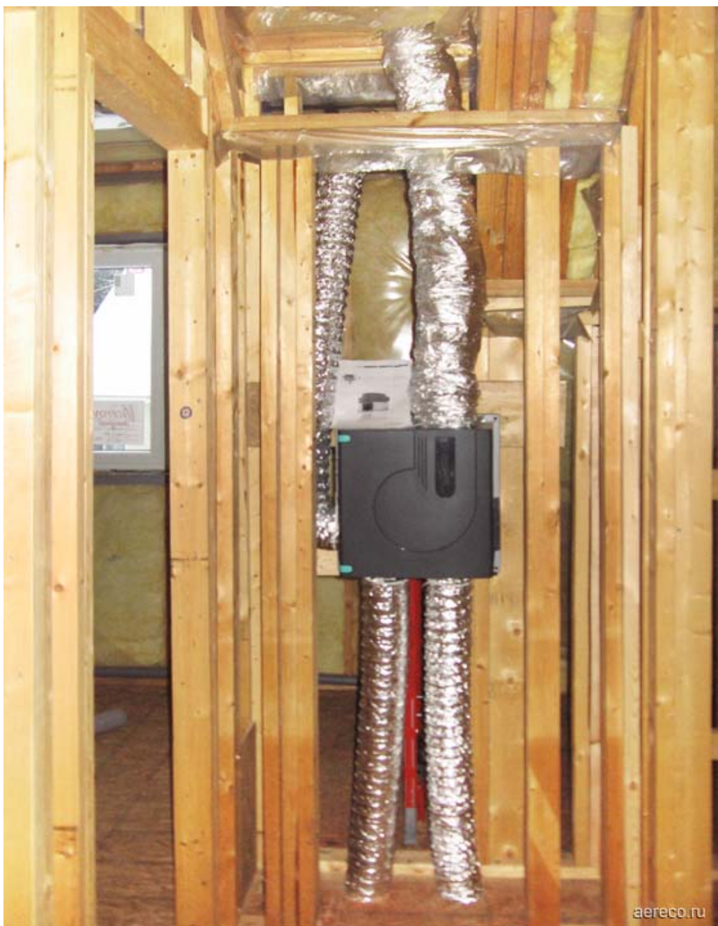
Вентилятор V4A, установленный в техническом помещении. При расходе воздуха 160 м 3 /ч, вентилятор потребляет всего 22 Вт.
