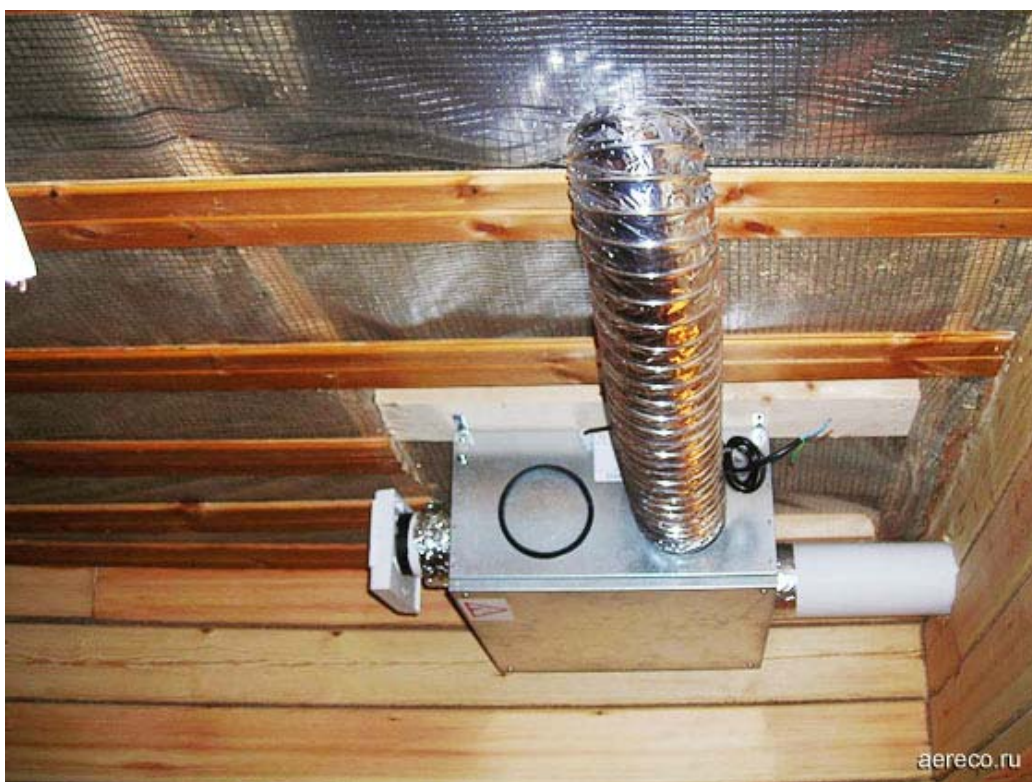
Вентилятор VAM, установленный на чердаке коттеджа.
