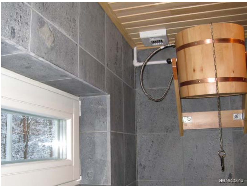
Вытяжное устройство ВХS с датчиком присутствия, установленное в предбаннике душевой.
