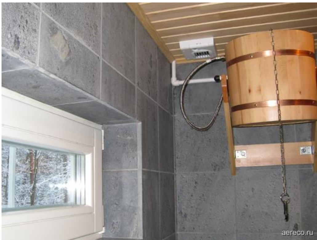
Вытяжное устройство с датчиком присутствия , установленное в предбаннике душевой.
